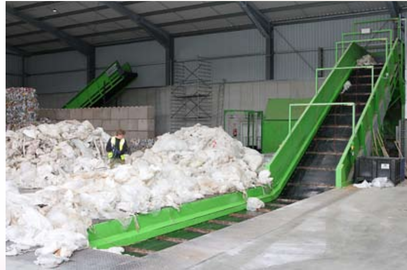
Das Foto zeigt die neue Ballenpresse mit Förderband für Altpapier und Kunststofffolien.
